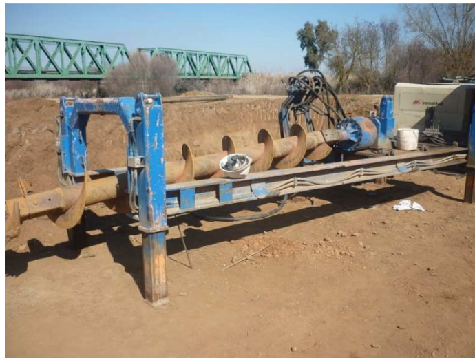
Vista de la Hélice que se encarga de la limpieza del tubo ya instalado.
