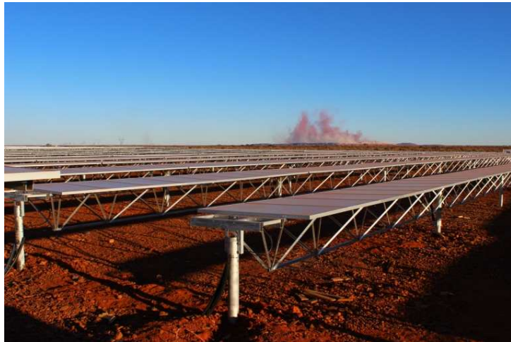
Parque fotovoltaico en Kathu (Sudáfrica). Todeca Perforaciones se encargó del hincado de los perfiles.
